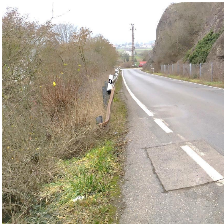
Obrázek 29 – Špatně ukotvené svodidlo (pohled směr Karlštejn)
